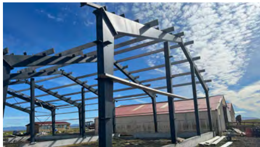
Hanna og Illugi hugðust stækka blóðmerarstarfsemi og voru að reisa húsnaði til þess arna þar til í fyrra. Þau eru nú að endurhanna húsnaðið með heimasláturhús og kjötvinnslu í huga.
